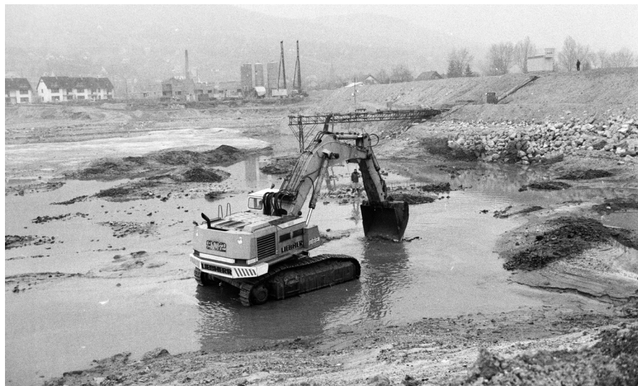
Ideiglenes Duna-meder létesítése a bős–nagyvarosi vízlépcsőrendszer építésekor, 1988 első felében Fortepan 250390/Vimola Károly
